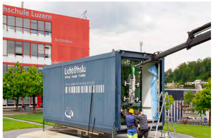
Der Lichtmesscontainer auf dem HSLU-Campus in Horw beim Einbau der elektrochromen Verglasung. Foto: Licht@hslu
