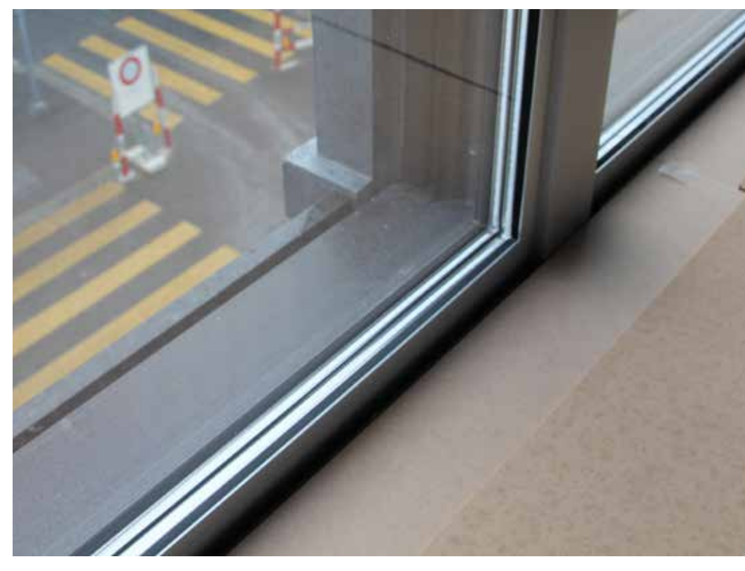
Die obersten paar Zentimeter der Rückseite des Granites wurden geschliffen, sodass die Oberfläche als Einheit in Erscheinung tritt.
