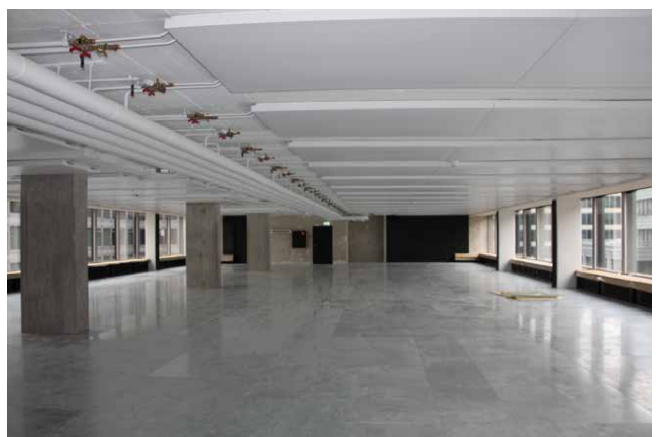
Deckenheizung, Technik bleibt sichtbar und ist zugänglich
