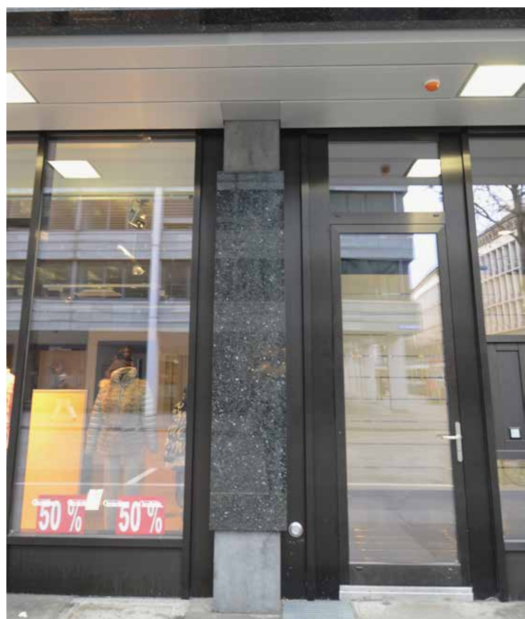
Betonpfeiler EG Granit nicht bis am Boden oder Decke, zeigt dass die der Naturstein vorgehängt ist und nicht eine tragende Funktion hat
