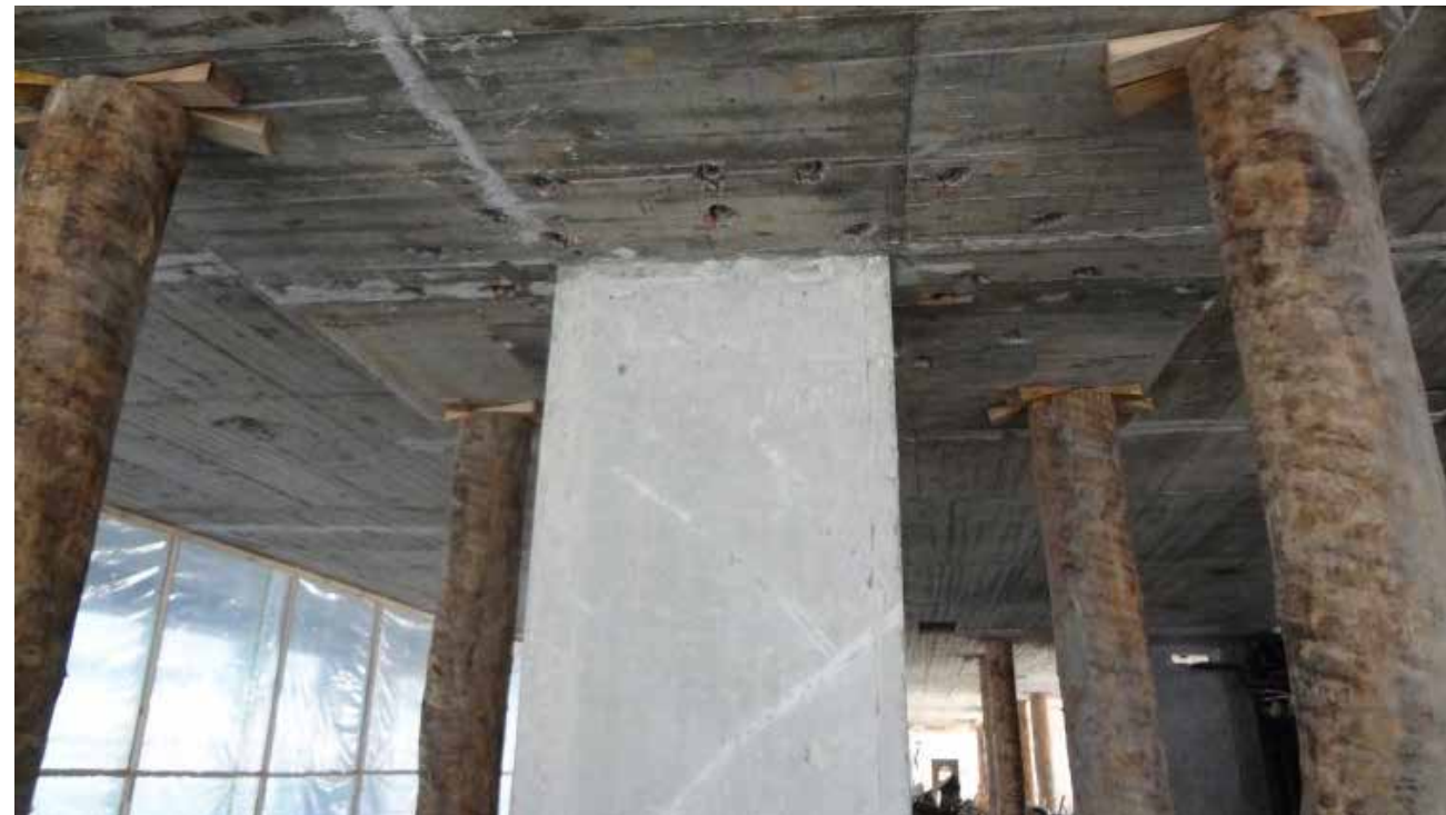
Eine umfassende Tragwerksanalyse zeigte, dass ungenügende Durchstanztragfähigkeiten den Fokus einer Sanierung dieses Mitte der 60er Jahre erstellten Bürogebäude bilden würde. Die Stützenköpfe der ausmittleig gelegte mittlere Stütze sowie zahlreiche Kräfteleitungen an Wänden müssten verstärkt werden.
