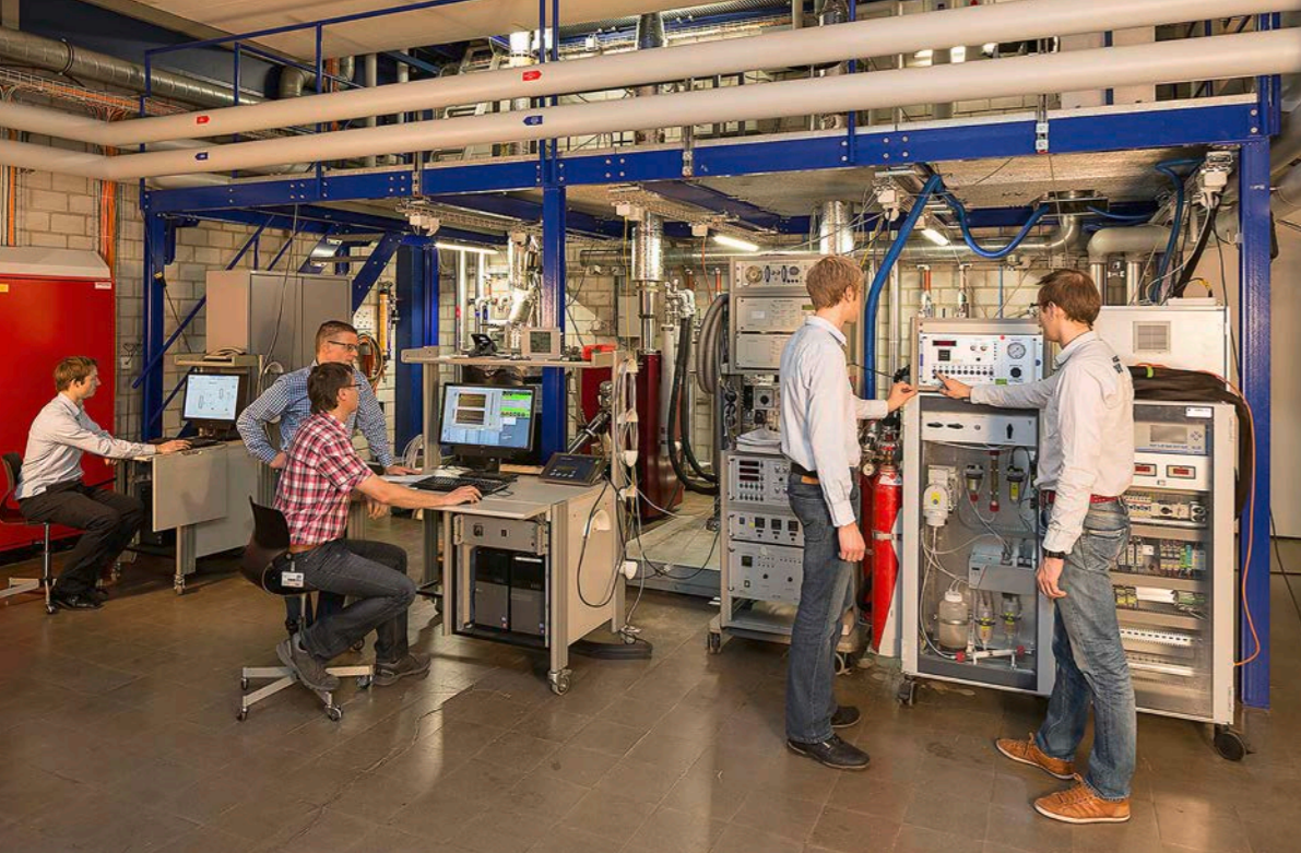
Das Forschungslabor Bioenergie an der HSLU.
